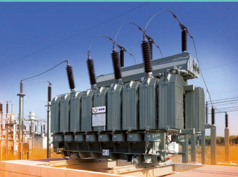
Beitrag zur Energiewende: SGB-Smit nutzt bluemint® powercore® zur Herstellung moderner Transformatoren.
